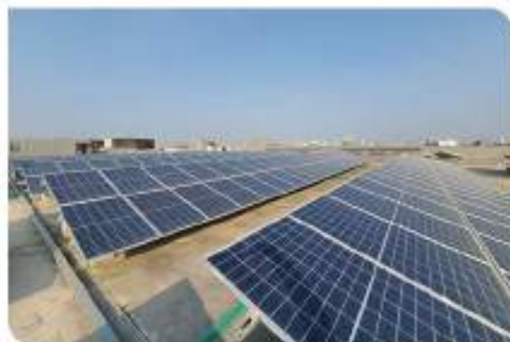
盐城东山精密产业园光伏电站项目
