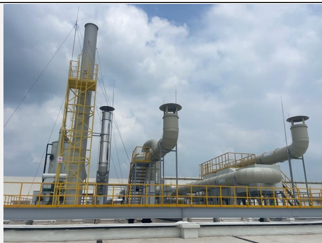
废气处理装置
